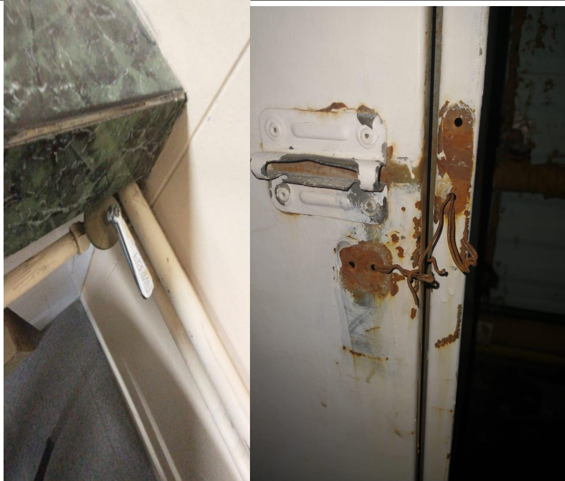
Gabinete del termotanque exterior, atado con alambre.
