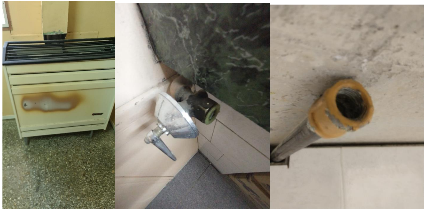
Imagen del calefactor de Biblioteca. Llave y caños de gas sin tapar.
